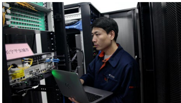
2019 年 12 月 19 日,化树明在机房调测专网链路
